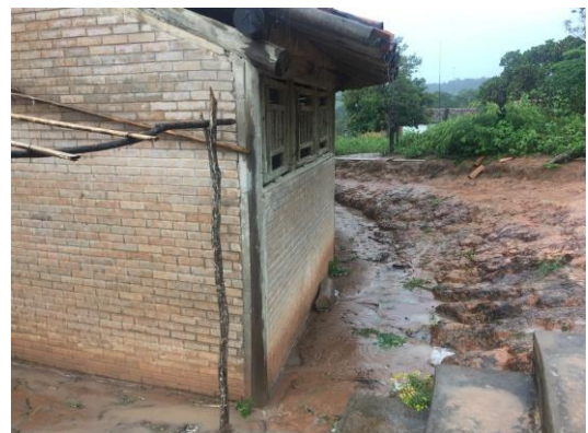
Imagem 48: erosão no quintal e infiltração na parede da casa. – Fonte: Próprios autores.
