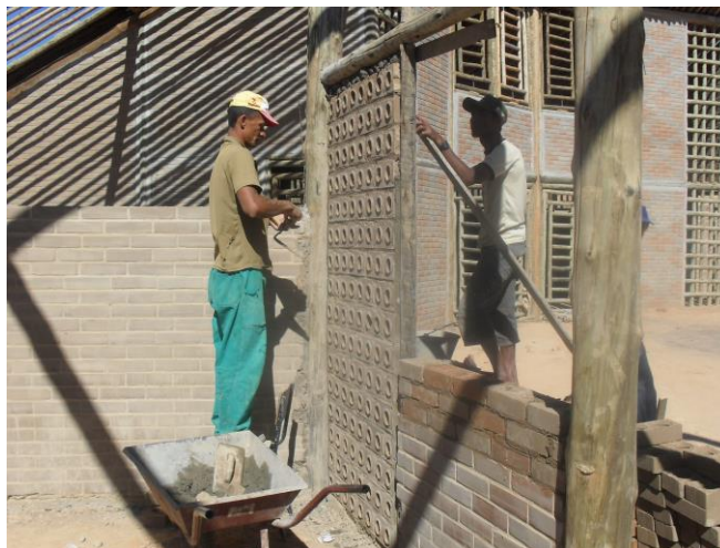
Imagem 23: Tijolo feito com a máquina manual sendo utilizado na obra. – Fonte: acervo Ponto de Cultura Loas.
