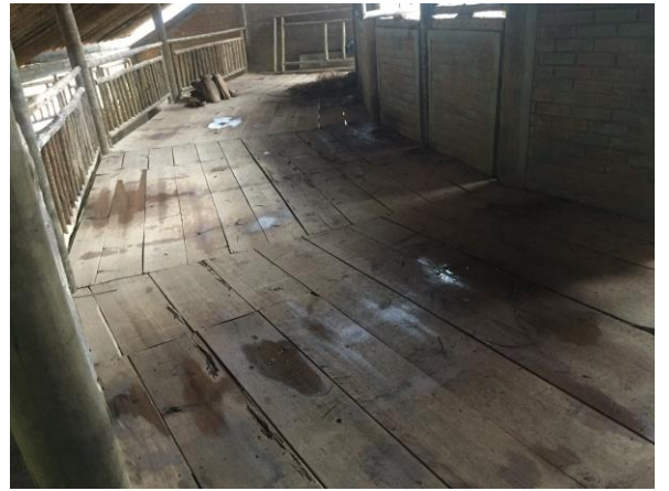
Imagem 44: tabuas molhadas do segundo piso devido à goteira da chuva. – Fonte: Próprios autores.
