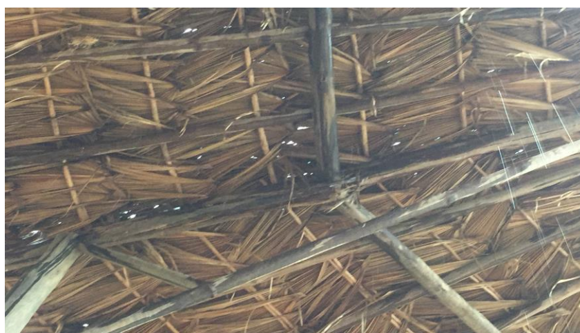
Imagem 42: estrago na tesoura do telhado central ocasionado pelo apodrecimento da madeira. – Fonte: Próprios autores.
