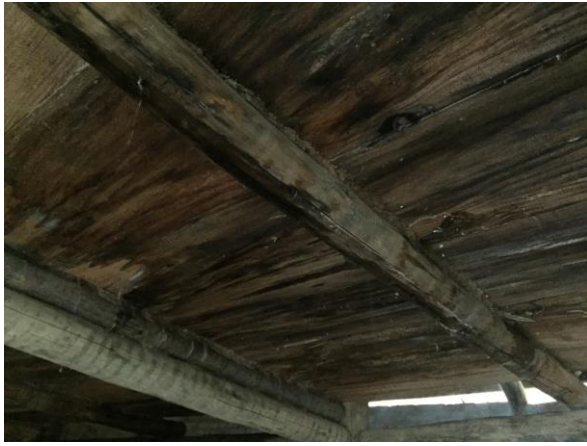
Imagem 43: apodrecimento das madeiras dos blocos internos. – Fonte: Próprios autores.
