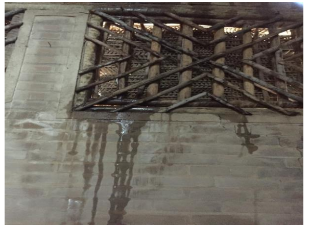
Imagem 46: janela com infiltração da água da chuva. – Fonte: Próprios autores.
