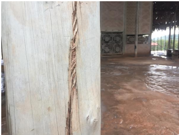
Imagem 45: estrago em um dos pilares central da casa. – Fonte: Próprios autores.
