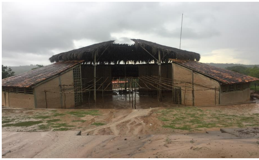
Imagem 39: Enxurrada inundando a arquibancada e o pátio central da casa. – Fonte: Próprios autores.
