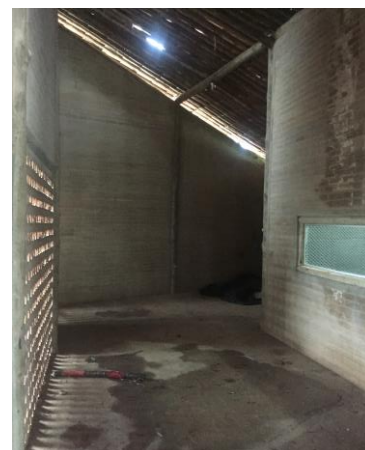
Imagem 41: alagamento no interior da casa, provocado pelo telhado que está estragado. – Fonte: Próprios autores.
