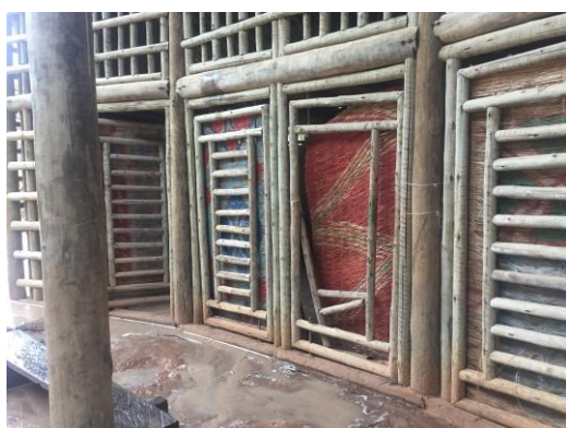
Imagem 40: Estrago nas portas. – Fonte: Próprios autores.
