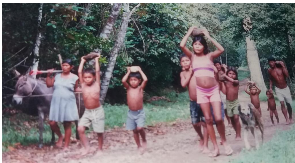
Figura 12 Crianças ajudando os pais a carregarem pedras para a construção do monumento, foto: Dan Baron, abril de 2001
