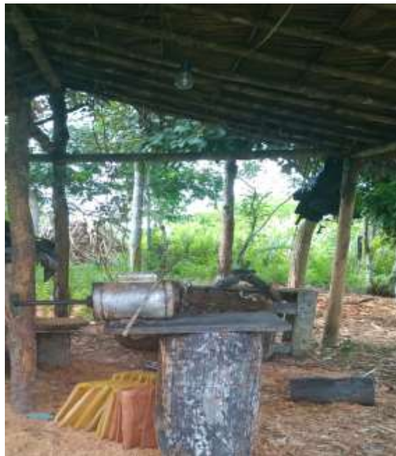
Imagem 10 - Motores elétricos instalados na Aldeia Boca da Mata. Arquivo pessoal da autora, 2019.
